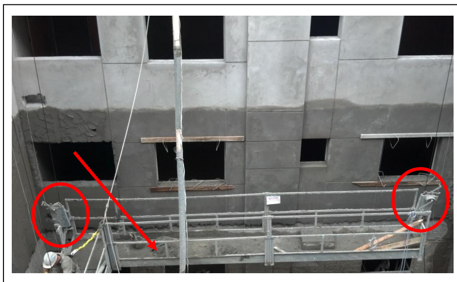
Figura 33 – Guincho e trava-quedas sem capa de proteção
