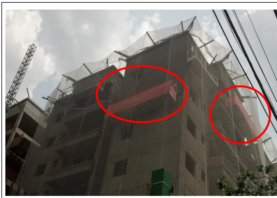
Figura 45 – Proteção de guarda-corpo em parte dos andaimes
