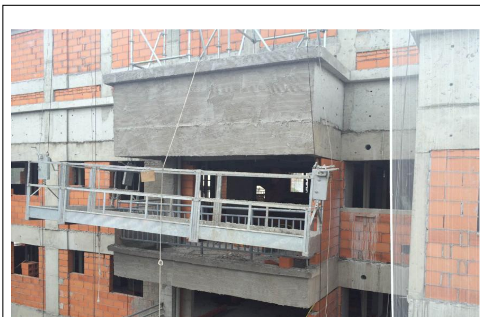
Figura 29 – Plataforma de trabalho sem tela de proteção do guarda-corpo Fonte: Arquivo pessoal (2015)
